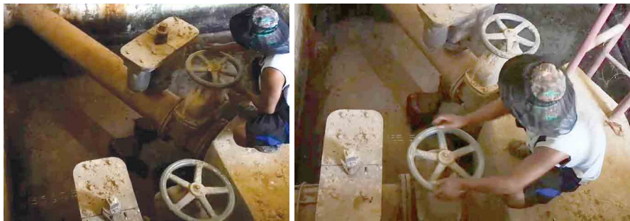
ภาพกรรมการกำลั้กน้ำที่เป็้ผู้เปิดวาล์วระบายอากาศเพื่อไล่ฟองอากาศในอาคารระบายน้ำ
