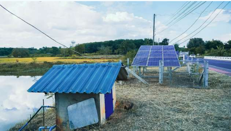
แผงโซลาร์เซลล์ติดตั้งแทนระบบไฟฟ้า
